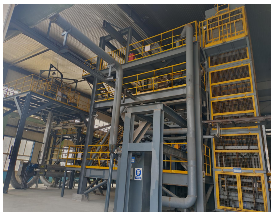
拆包破碎系统-2 线
