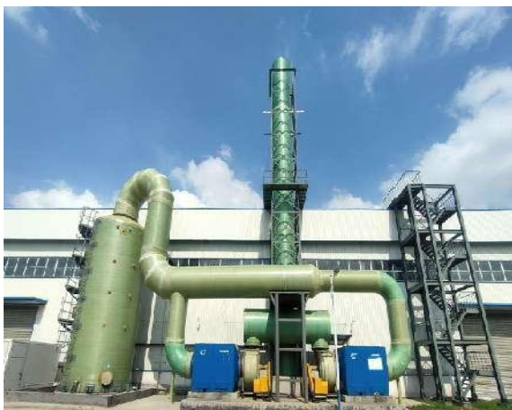
3#污盐仓库西侧暂存废气 DA002 (碱吸收+活性炭)
