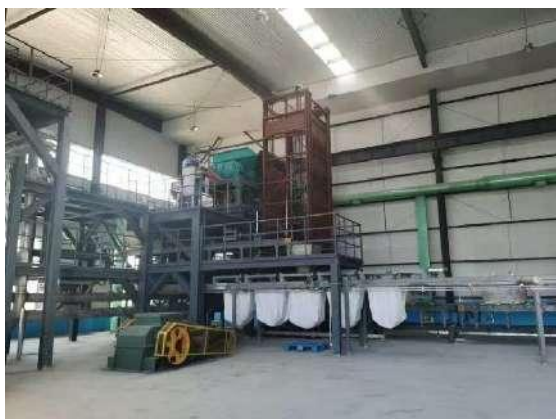
拆包破碎系统-1 线
