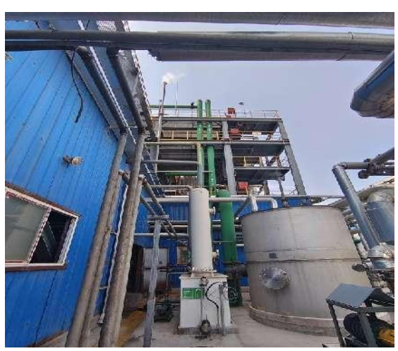
精制废气 DA009 (碱吸收)
