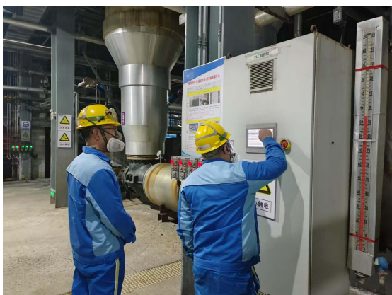
MVR 蒸发系统
