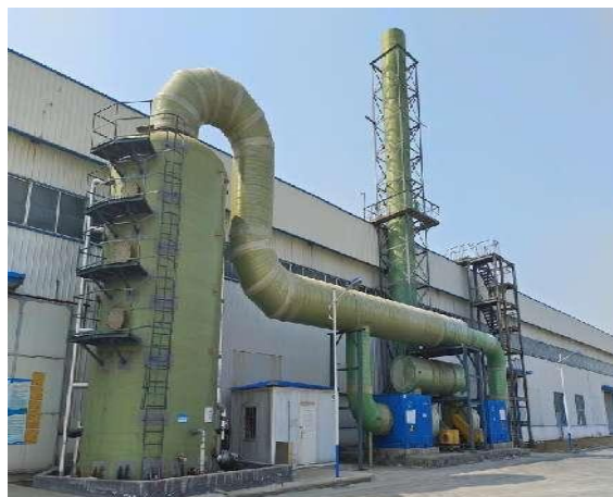
3#污盐仓库东侧暂存废气 DA003 (碱吸收+活性炭)
